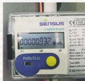
Les compteurs d'énergie connectés facilitent les bilans. ©GIE Elevages de Bretagne
